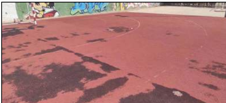
Fotografía 4: Detalle de deterioro.
