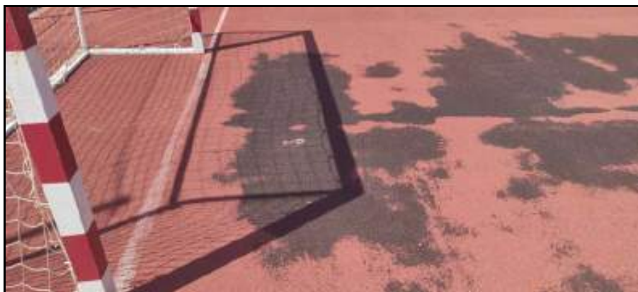
Fotografía 2: Detalle de deterioro.
